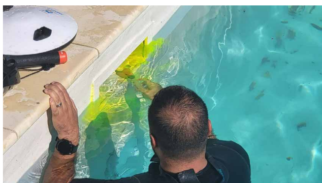
Test d'étanchéité des pièces de scellement skimmer N°1: Infiltrante.
