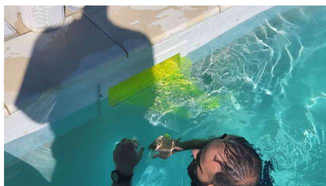
Test d'étanchéité des pièces de scellement skimmer N°2: Infiltrante.
