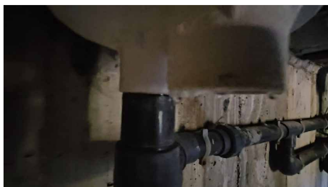
Socle des skimmers 1 et 3 fissurés
