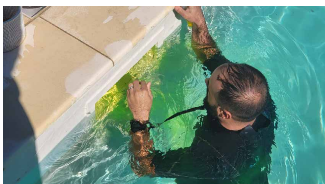
Test d'étanchéité des pièces de scellement skimmer N°3: Infiltrante.
