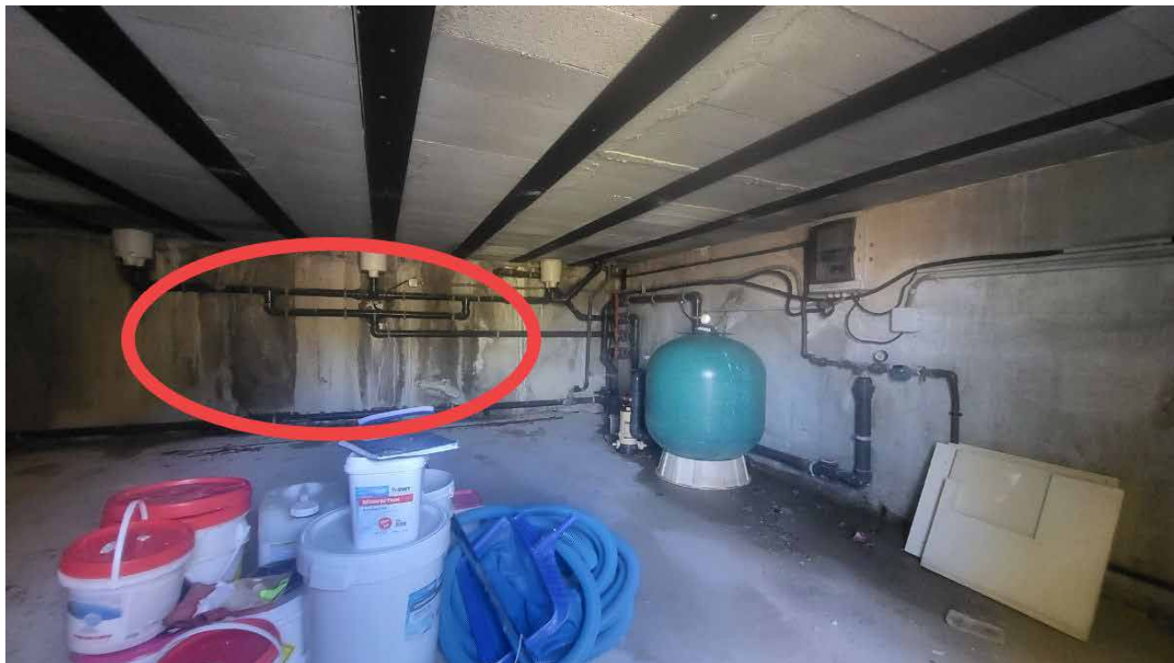
Zone sinistrées par les infiltrations.
